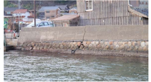
航路護岸のひび割れ状況
