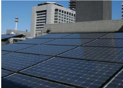
屋上を利用した太陽光発電
