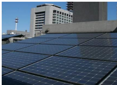
屋上を利用した太陽光発電
