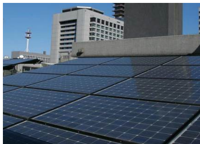
屋上を利用した太陽光発電
