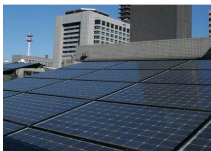
屋上を利用した太陽光発電
