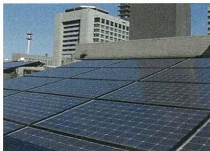
屋上を利用した太陽光発電 (平成14年10月設置)
