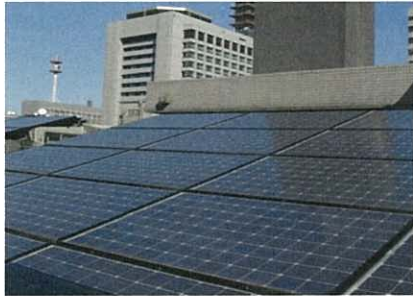
屋上を利用した太陽光発電
