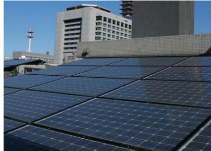
屋上を利用した太陽光発電
