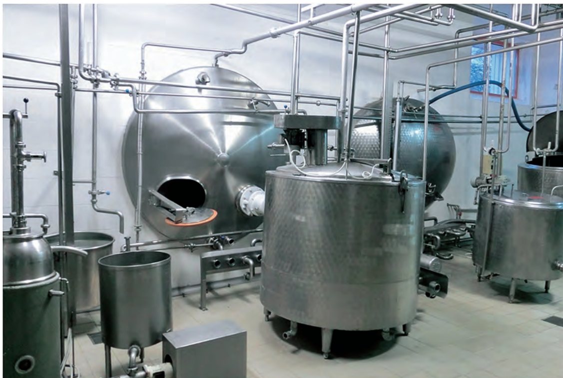
写真2 CAP 補助金により整備された乳製品加工事業所の加工施設
