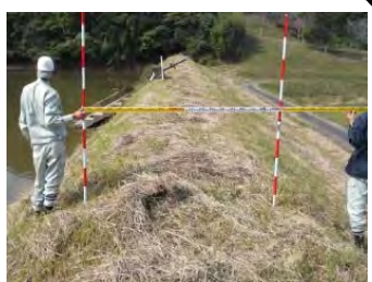
断面不足の堤体
