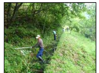
山腹水路の維持管理状況
