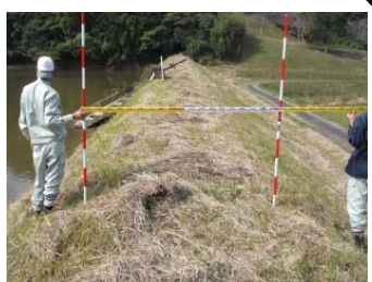
断面不足の堤体
