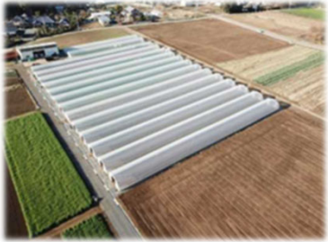
散水チューブをハウス内に設置
