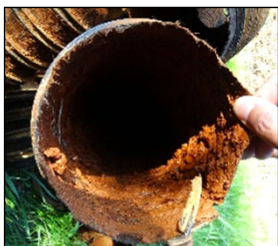
吸水管の目詰まり状況
