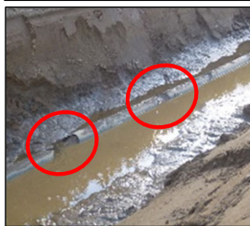
集水管の破損
