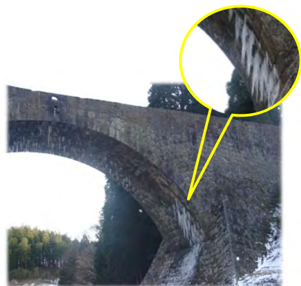
漏水と冬期の凍結
