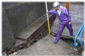
老朽化のため破損した開水路
