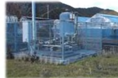
・揚水施設の設置 ・パイプライン等の整備
