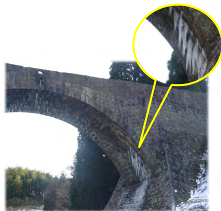
漏水と冬期の凍結
