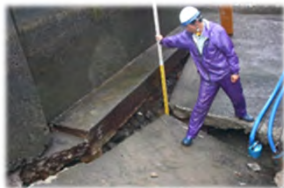
老朽化のため破損した開水路
