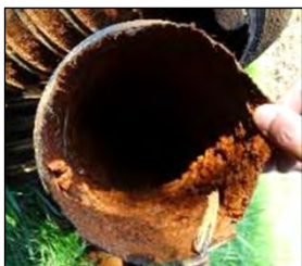
吸水管の目詰まり状況
