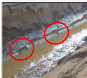
集水管の破損
