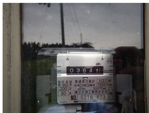
④ 電力メーターの計測
