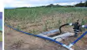
各ほ場に設置された給水栓
