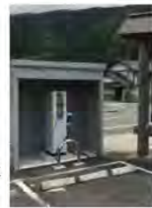
駐車場に設置されたEV用急速充電器
