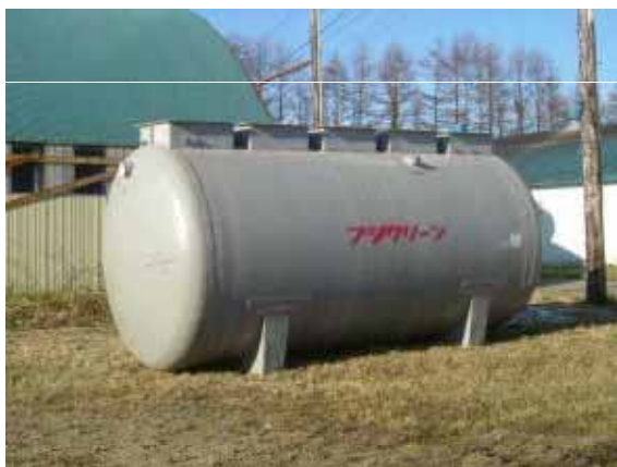
畜舎廃水用浄化処理槽の全景
