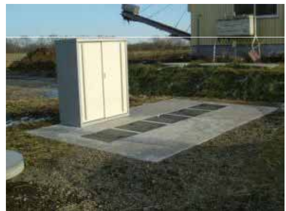
畜舎横に埋設した畜舎廃水用浄化処理槽
