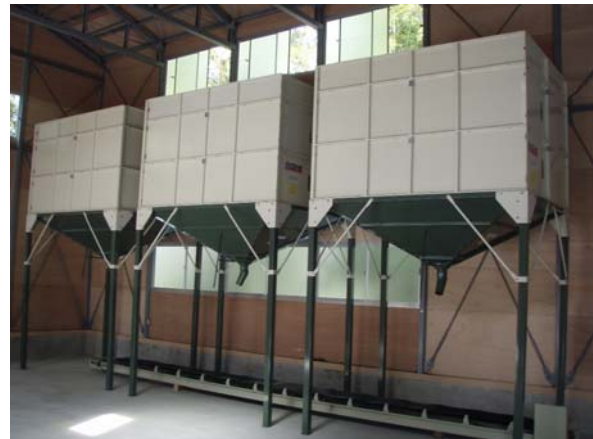
【施設内にある粃貯蔵タンク】
