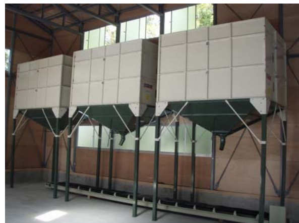
【施設内にある粃貯蔵タンク】
