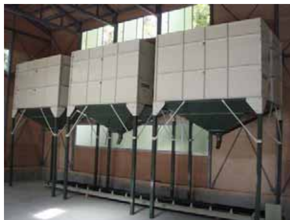
【施設内にある粉貯蔵タンク】
