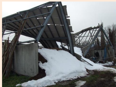
倒壊した堆肥舎
