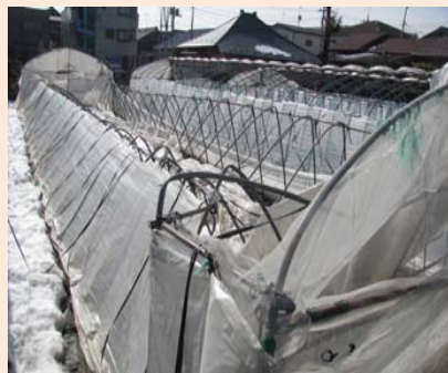
完全倒壊したハウス
