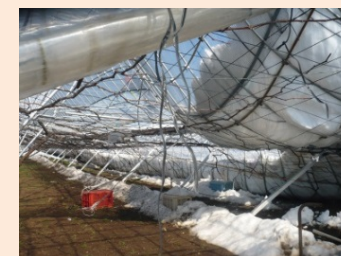
倒壊ハウスの調査
