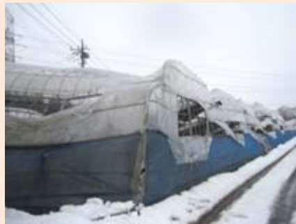
倒壊したハウス
