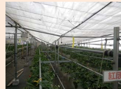
天井部が押しつぶされたイチゴハウス
