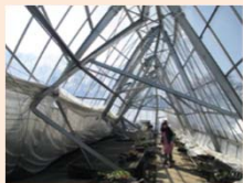
倒壊した鉄骨ハウス
