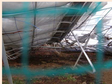
倒壊したぶどうハウス内部
