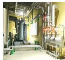
蒸気ボイラー
