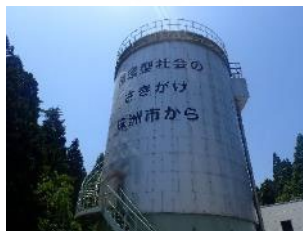
メタン発酵槽
