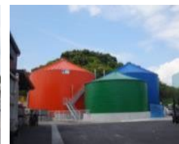
メタン発酵槽・消化液槽
