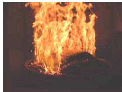
ボイラー内での燃焼の様子
