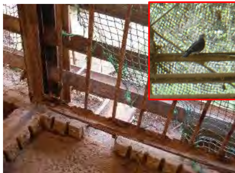
防鳥ネットの破損。調査時に鳩の侵入を確認。
