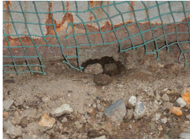
豚舎外壁にねずみが入り出す穴あり。
